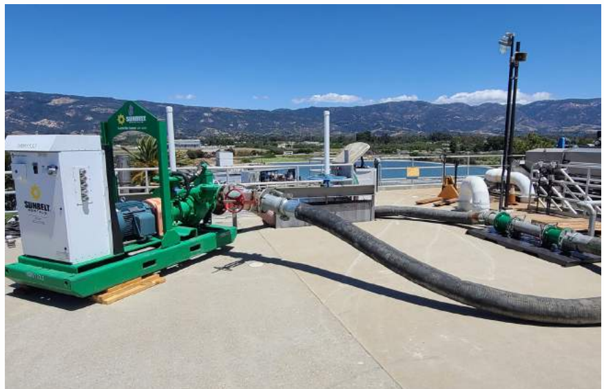
Installation temporaire au GSD pour la période d'essai.
