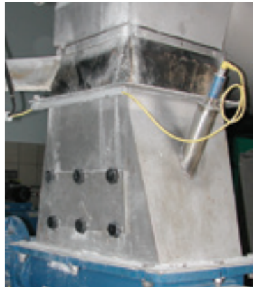
Module de gestion de niveau
