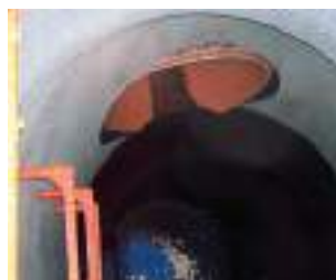
MANQUE D'ÉTANCHÉITÉ SUR REGARDS EN BÉTON
