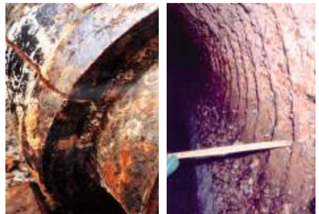
EFFETS DE LA CORROSION EXTÉRIEURE ET INTÉRIEURE SUR LES TUYAUTERIES
