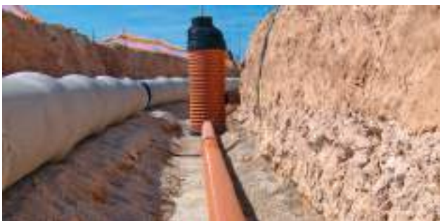
COLLECTEUR ET REGARDS SANECOR® POUR EAUX USÉES À CÔTÉ DE COLLECTEUR D'EAUX DE PLUIE EN BÉTON
