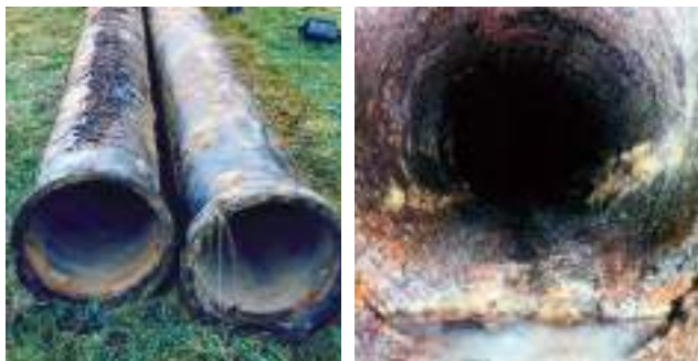
TUYAUTERIES AYANT SUBI DES ATTAQUES DE CORROSION ÉLECTROCHIMIQUE
