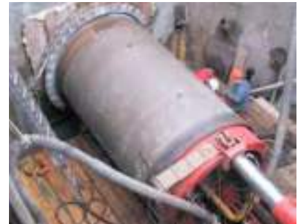
Béton polymère (tuyauteries de battage)
